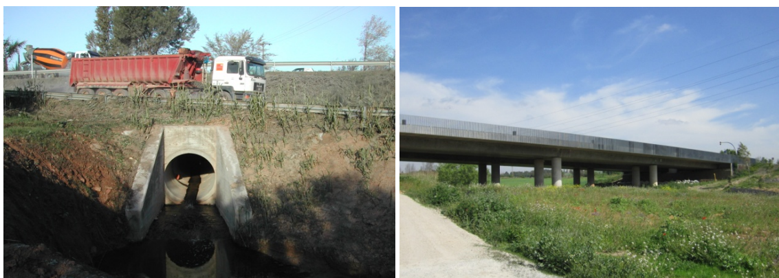
Figura 1 Carretera BP-1413 al torrent de Can Fatjó. A l'esquerra (en primer terme) s'observa el drenatge de 1,5 m de diàmetre existent abans de l'execució de les obres previstes en el projecte del Corredor Verd del Parc de l'Alba. A la dreta es mostra el viaducte de 125 m d'amplada existent en l'actualitat. Fotos: IGR 2006 i Minuartia.
