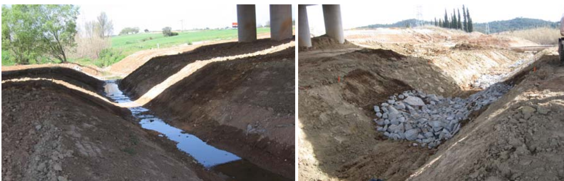
Figura 3 Llera del torrent de Can Fatjó sota el viaducte de la carretera BP-1413 . A dalt secció longitudinal de la llera sota el viaducte. A la foto de l'esquerra s'observa la secció de la llera restituïda i en la foto de la dreta l'execució de la protecció realitzada. Fotos: Consorci Centre Direccional
